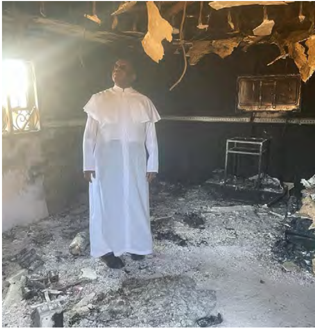
→ Dewan inspecciona uno de los edificios quemados.
